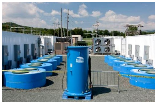
Рис. 7 Накопитель мощностью 20 МВт в г. Стефентаун, штат Нью-Йорк, США на маховиках фирмы BeaconPower.
