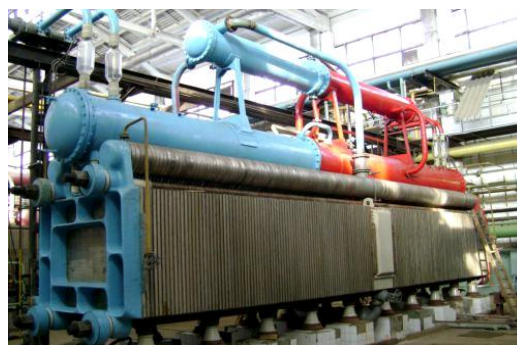
Рис. 8 Электролизер ФВ-500 М производства ОАО «Уралхиммаш» производительностью 536 м 3 /ч водорода с чистотой 99,5 % при давлении 0,01 МПа.
