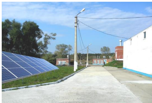
Рис. 13 Фотоэлектрическая солнечная установка на очистных сооружениях ООО «ЕвроХим-БМУ» в г.Белореченске Краснодарского края (проект института «Ростовтеплоэлектропроект»)
