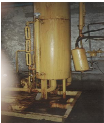
Рис. 5. Оборудование теплопункта с. Медведевка
