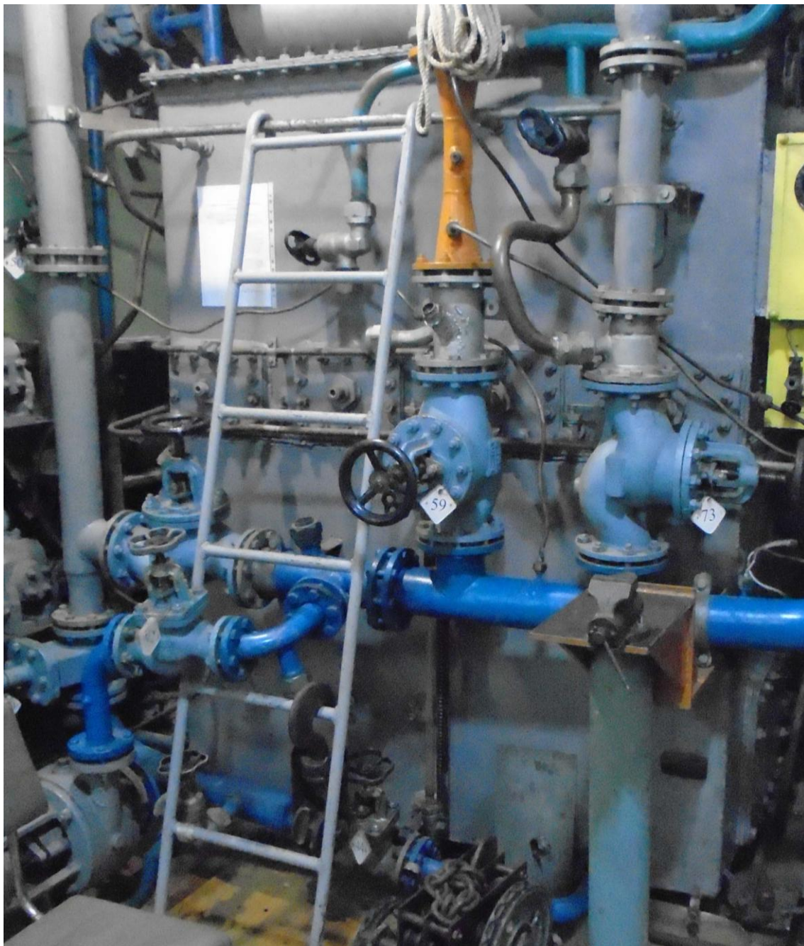
Рисунок 1.13 – Общий вид теплового ящика котельного отделения
