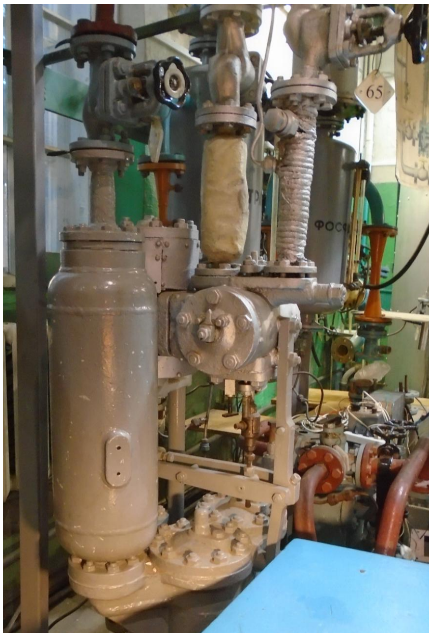
Рисунок 1.11 – Общий вид запасного топливного насоса котла КВС-68
