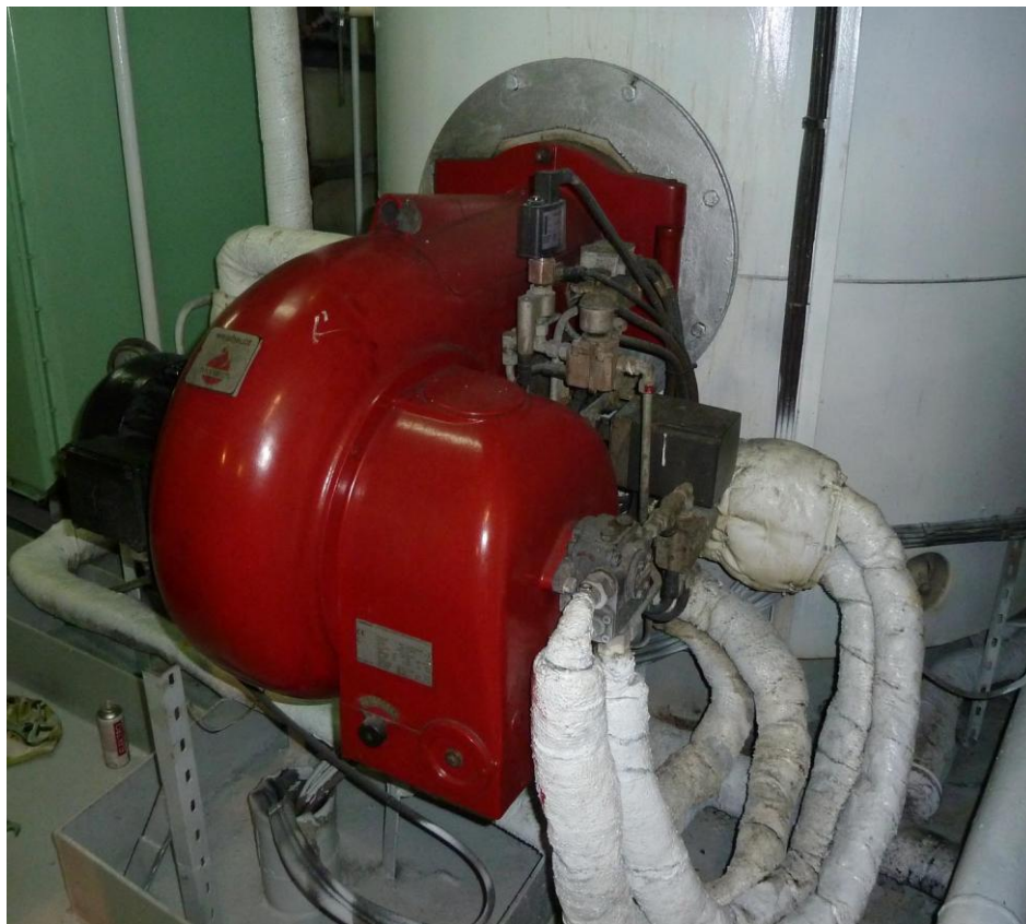
Рисунок 2.16 – Форсуночный агрегат, установленный на котле
