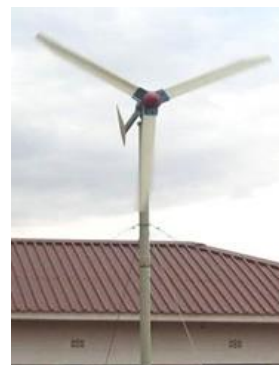
Рис. 1. ВЭУ мощностью 1 кВт, EuroWind 1
