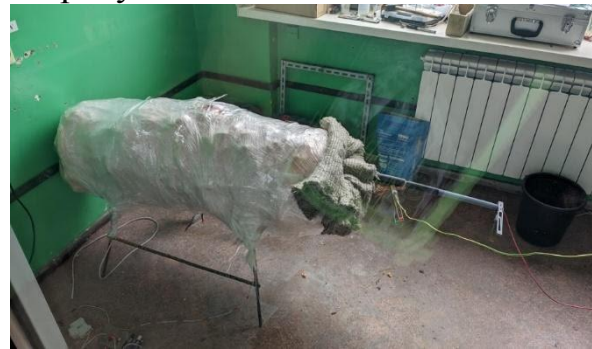
Рис. 9. Работающая установка покрытая базальтовым утеплителем.
