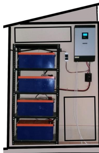
Рис.4. Размещение аккумуляторов для электроустановки
