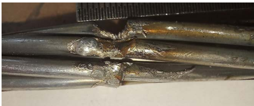
Рис. 4. Последствие межфазного замыкания
