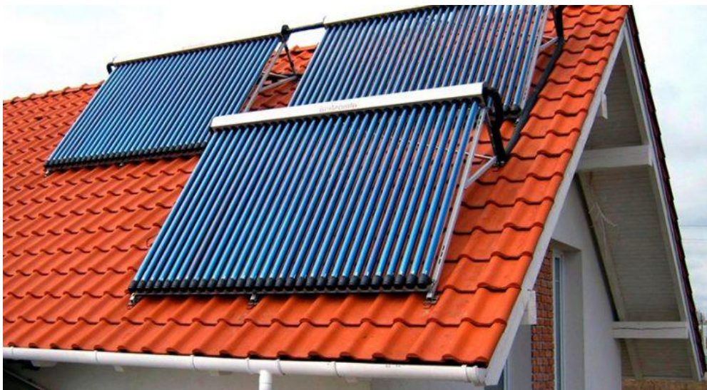
Рисунок 2.6 – Плоские солнечные коллекторы на крыше дома
