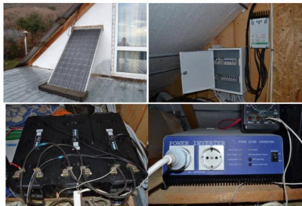
Рис. 1 Фотоэлектрическая установка с аккумуляторными батареями, установленная на площадки кровли
