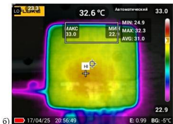
Рис. 7. Данные теплового контроля работы. а – распределение температуры корпуса сразу после включения, б – распределение температуры корпуса в установившемся режиме
