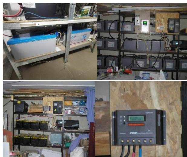
Рис. 5. Основное и вспомогательное оборудования автономных солнечных электростанций (инверторы, аккумуляторные батареи, контроллеры и др.)
