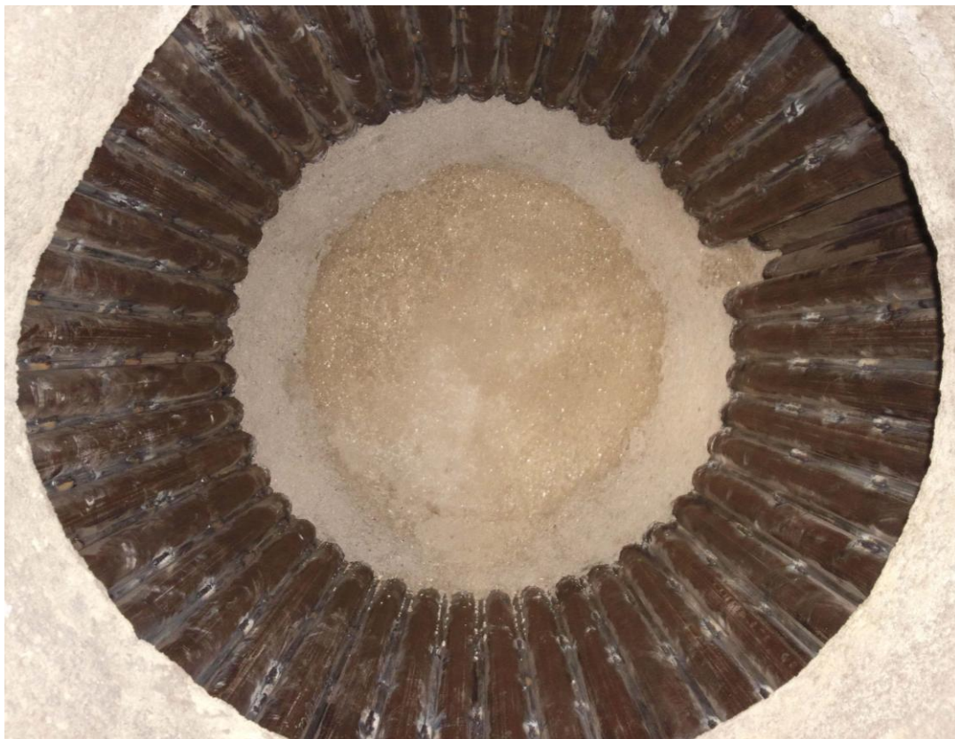
Рисунок Ф.3 – Вид на топку котла со стороны форсунки
