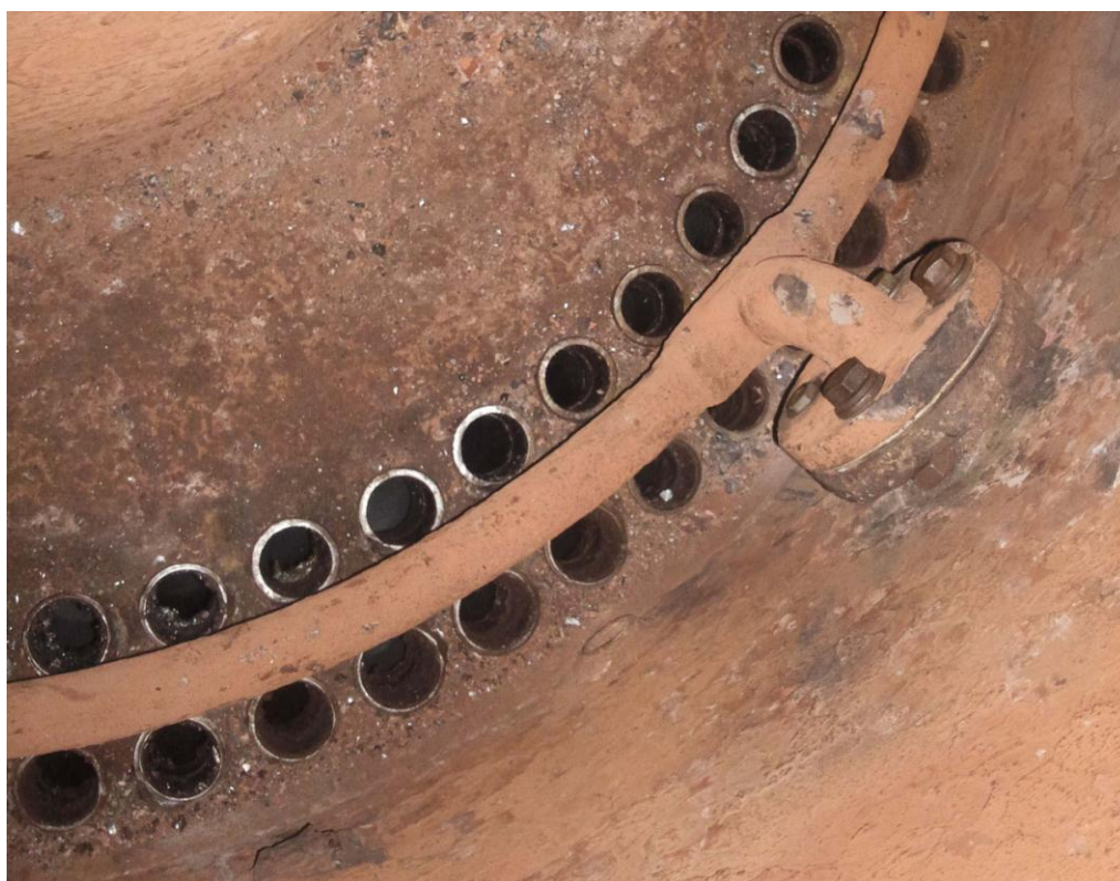
Рисунок Ф.4 – Вид на трубную доску из пароводяного коллектора
