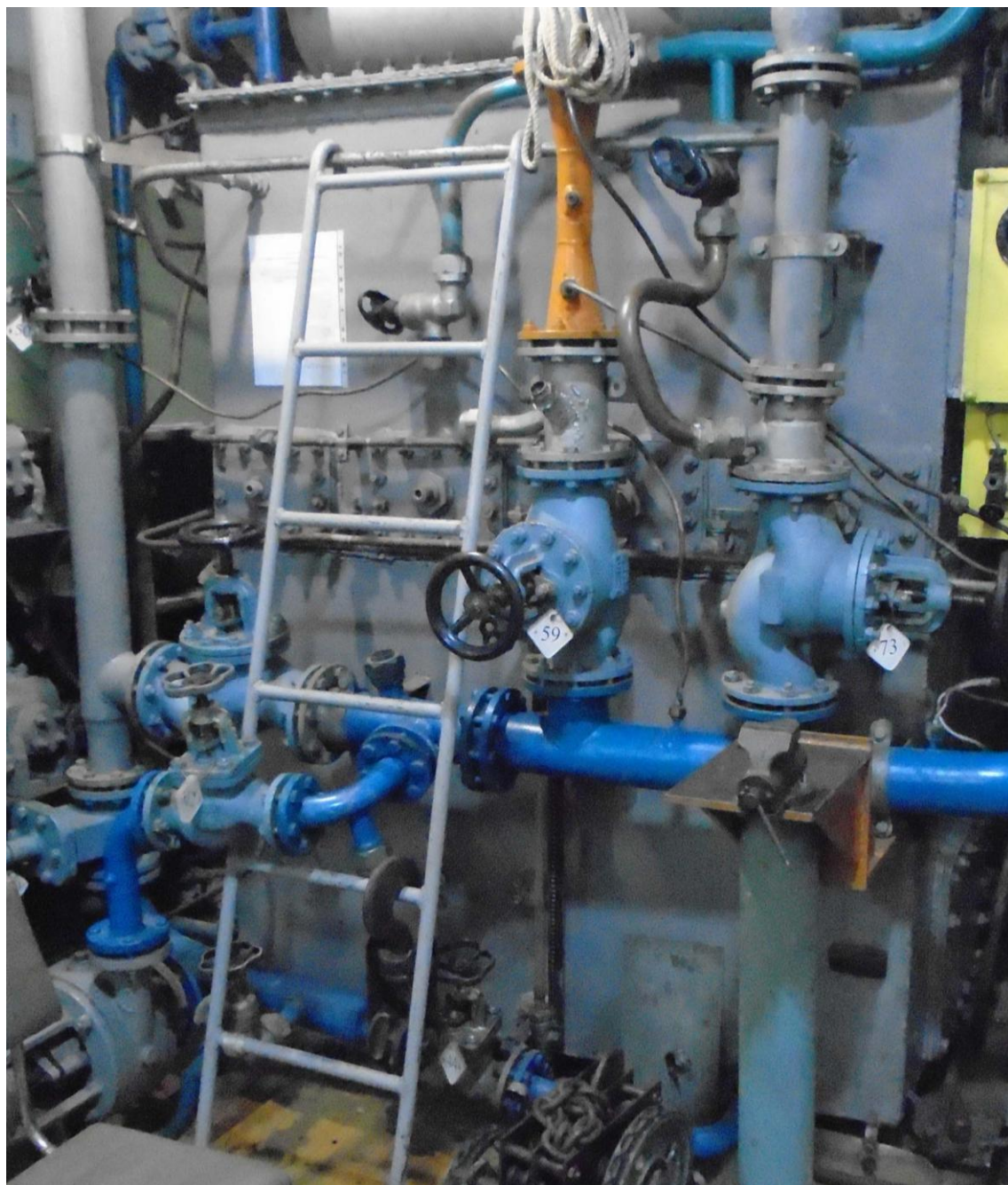
Рисунок 1.13 – Общий вид теплового ящика котельного отделения
