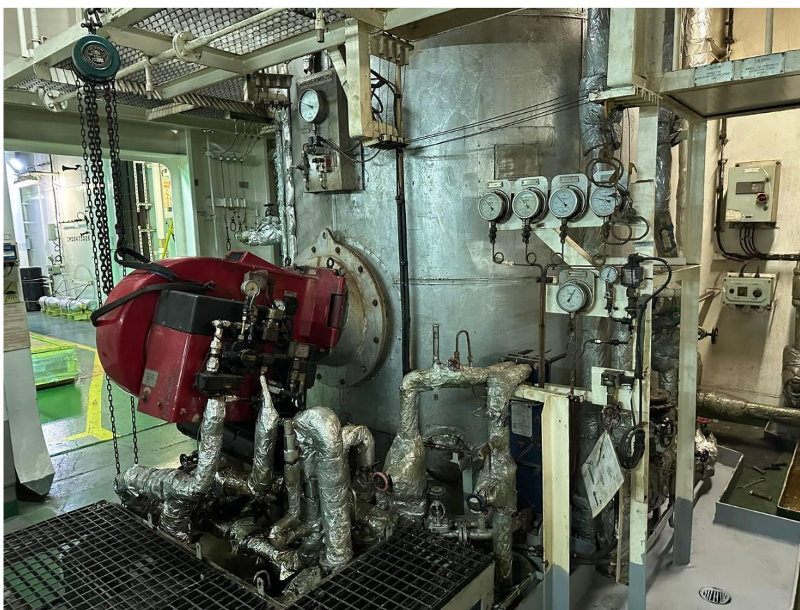
Рисунок 3.15 – Форсуночный агрегат, установленный на котле
