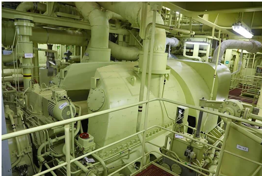
Фото 2.5. Генераторы филиала ОАО "Силовые машины" "Электросила" [12]
