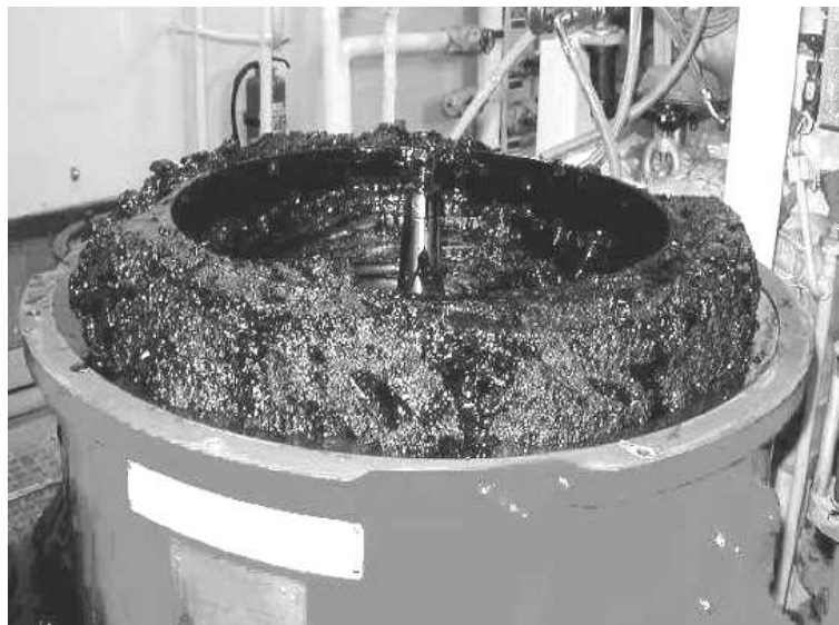
Рисунок 2 – Вид сепаратора топлива в состоянии частичной разборки после работы с аварийной смесью топлив
