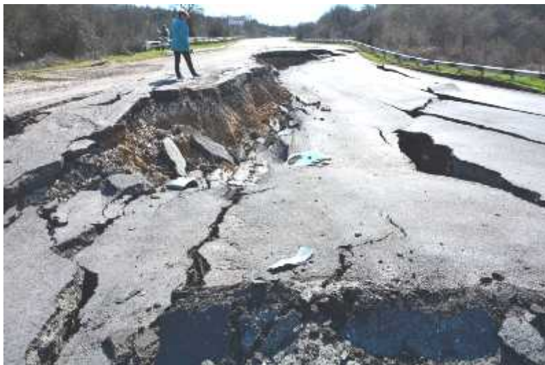
Рис. 4.8. Деформация дорожного полотна, в результате активного оползневого процесса (Крым)
