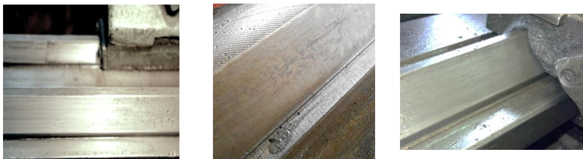
Рис. 2. Износ и повреждения направляющих
