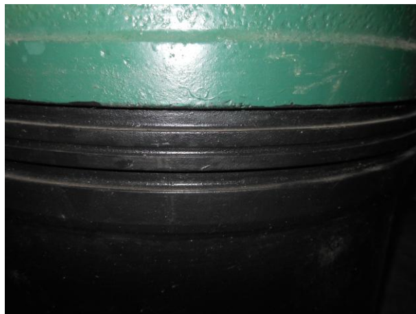
Рисунок А.40 – Осмотр поверхностей нижнего уплотнительного пояса втулки цилиндра дизеля типа 8ZD72/48
