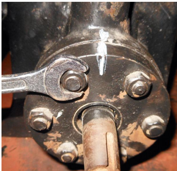
Рисунок Б.49 – Ослабление затяжки гаек крепления крышки уплотнения коленчатого вала к корпусу подшипника
