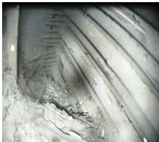
Рис. 5. Повреждения трубного пучка ПГ.
