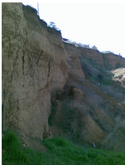
Фото 6. Стенка срыва оползня (вид сбоку) далее ниже – обвальные массы, уже задернованные, с растительностью, тропинками, местами под костры и т.п.
