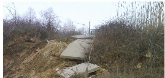
Фото 4. Разрушенная и смещенная оползнем лестница – выход с кемпинга на пляж, апрель 2008г.
