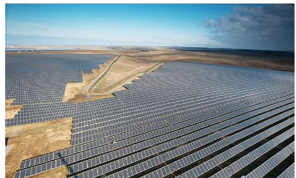
Рис. 1. Солнечная электростанция, Перово, Крым, мощность: 105,56 МВт, площадь: 2000 г.
