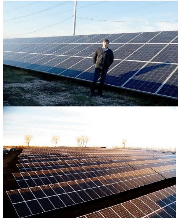
Рис. 4. Затенение фотоэлектрических модулей на солнечных электростанциях
