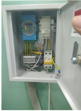
Рис. 9 – Внешний вид шкафа
