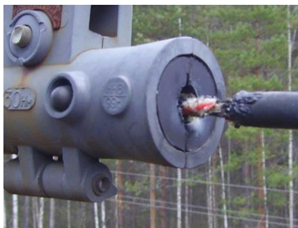
Рис. 1 Разрушение оболочки вследствие коронных разрядов
