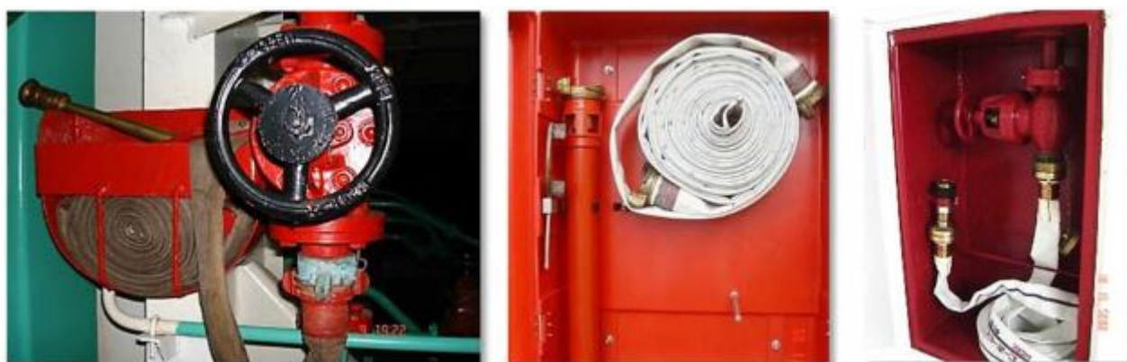
Фото 7.7. Ящики для хранения пожарного рукава
